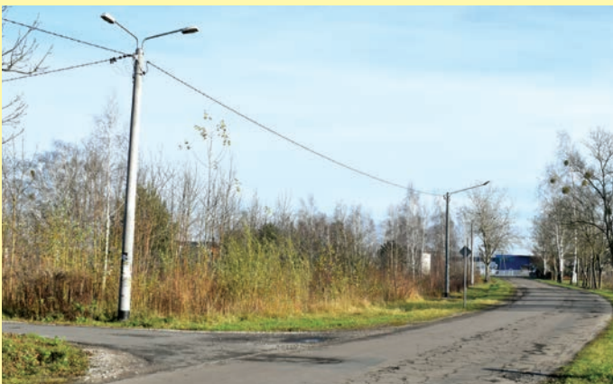
Kolonia Jaktorów, ul. Armii Krajowej – oświetlenie uliczne
